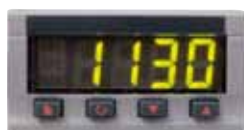
Régulateur de sécurité de surchauffe
