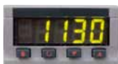
Régulateur de sécurité de surchauffe
