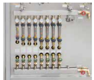
Circuit d'eau de refroidissement
