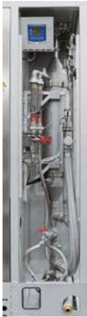
Système de lavage pour la purification des gaz d'échappement du processus par lavage
