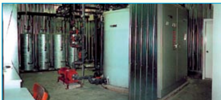
Installation de potabilisation de l'eau : Débit 30 m 3 / heure, soit 800 m 3 / jour.
